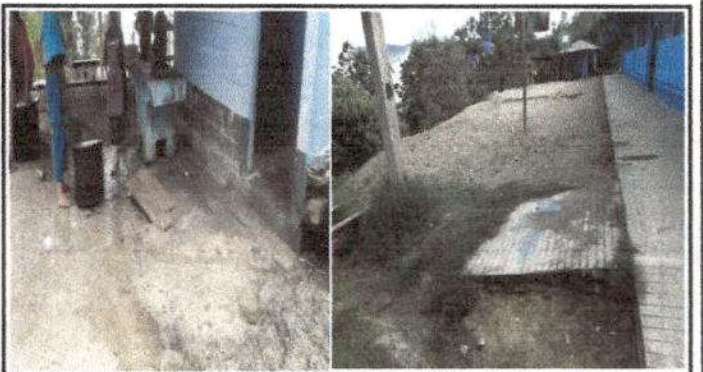
Foto 6: Estado Actual del losa de patio de cocina y escuela.
