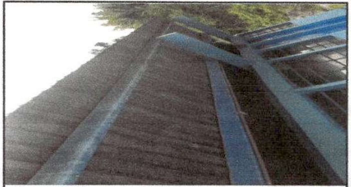
Foto 2: Estado actual de estructura de soporte de metal
